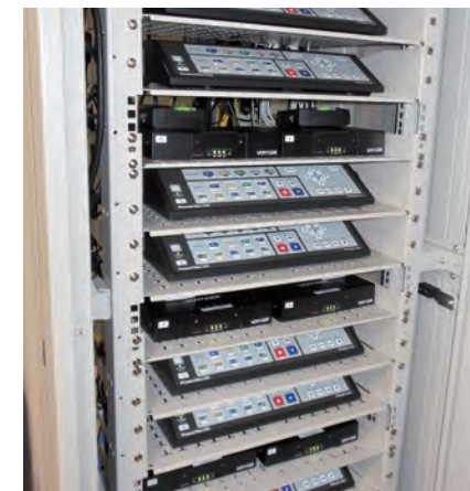
サーバールームの「Power Rec SS」
