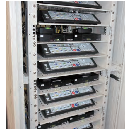
サーバールームの「Power Rec SS」
